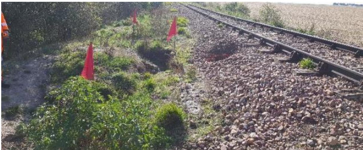
Figure 18 : Exemple récent de terriers dans un remblai près de Pithiviers (45) ayant entraîné l'arrêt de la circulation des trains (source : SNCF Réseau).
